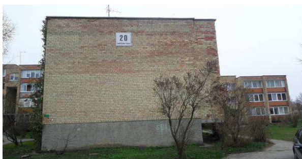
7 pav. Vakarinis fasadas, aptrupėję plytos
