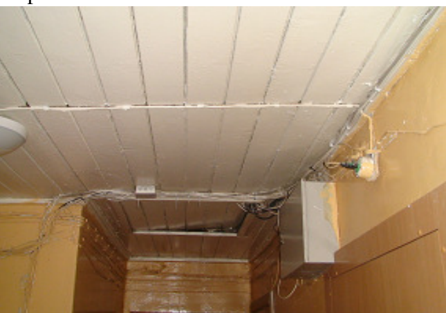
15 pav. El. instaliacija laiptinėje
