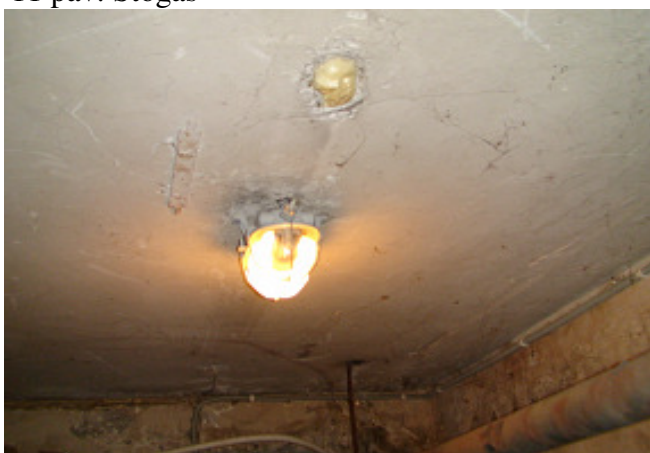
13 pav. El. instaliacija rūsyje
