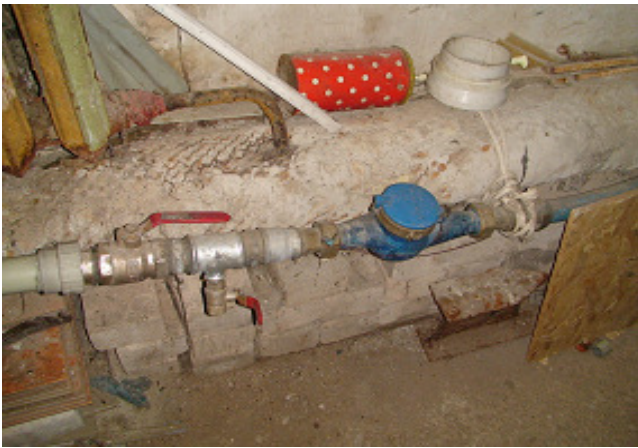
15 pav. Šalto vandens vamzdis
