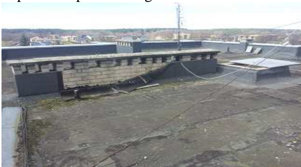
11 pav. Atplyšusi hidroizoliacinė danga
