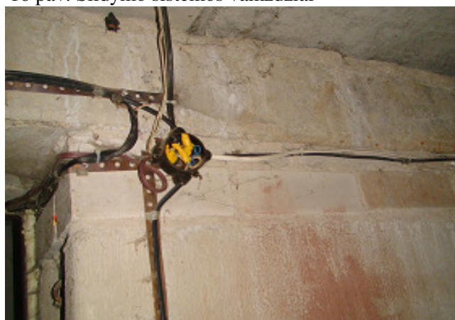
18 pav. El. instaliacija rūsyje
