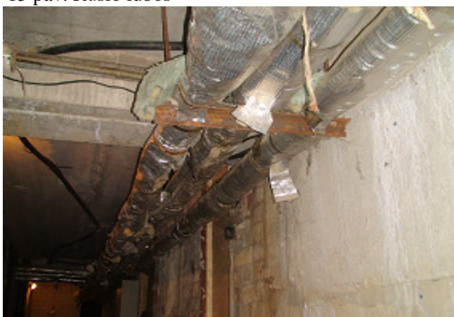
17 pav. KV vamzdynai rūsyje
