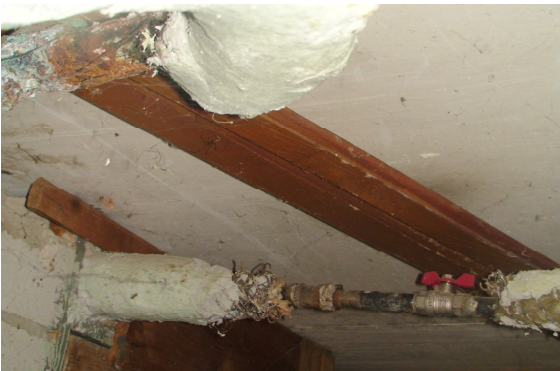
17 pav. Šalto vandens vamzdis
