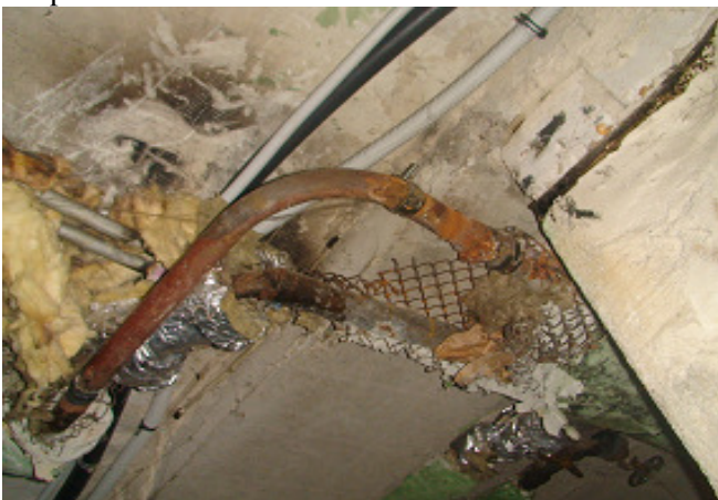
17 pav. KV vamzdynai rūsyje
