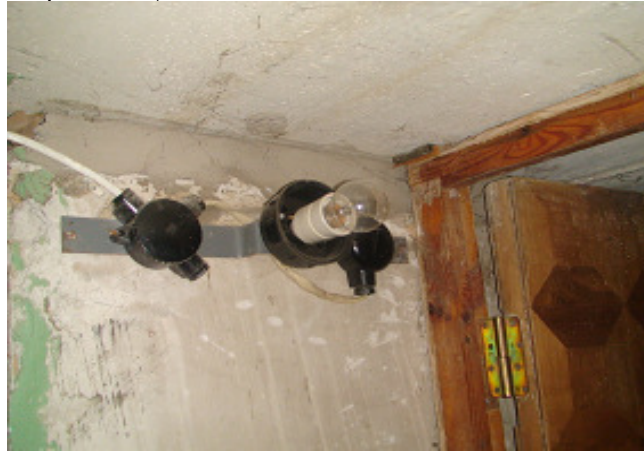
18 pav. El. instaliacija rūsyje
