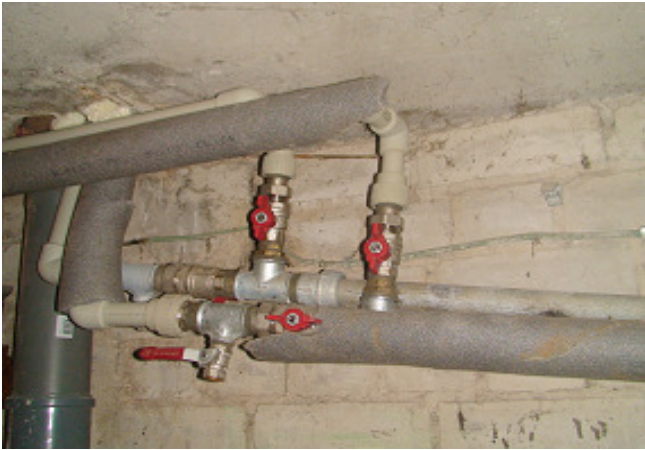
17 pav. KV vamzdynai rūsyje
