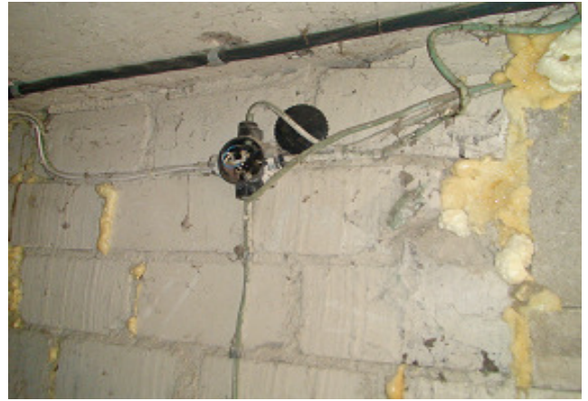
18 pav. El. instaliacija rūsyje
