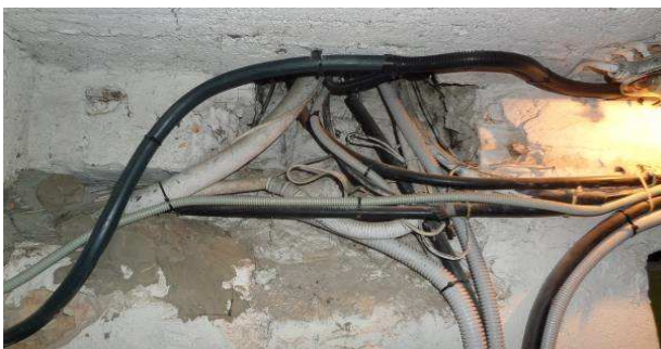
16 pav. Elektros instaliacija rūsyje
