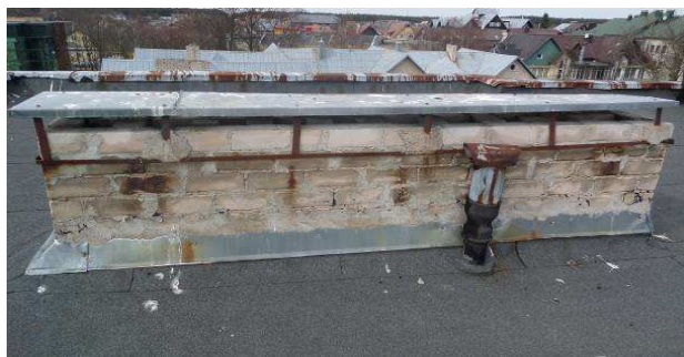
16 pav. Ventiliacijos angos
