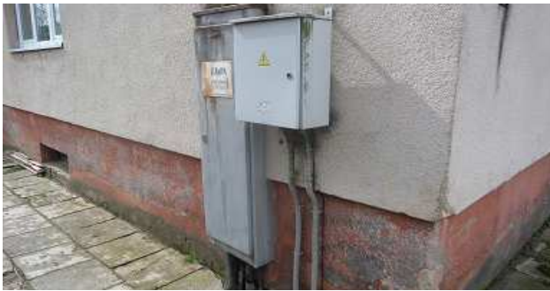
7 pav. Rūsio langai, cokolis, el. įvadinė spinta
