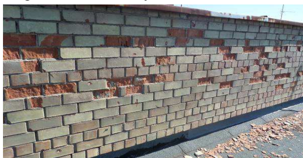
14 pav. Aprtrupėję parapetai
