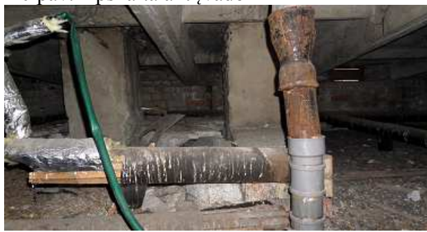
12 pav. Vamzdynai techniniam aukšte-palėpėje
