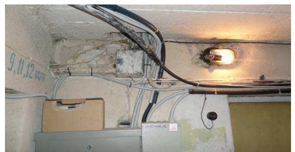
16 pav. Elektros instaliacija rūsyje
