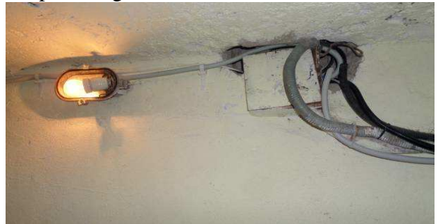
17 pav. Elektros instaliacija rūsyje
