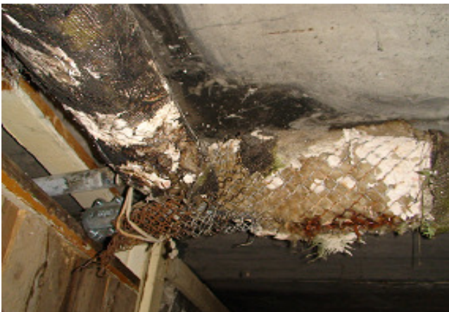
15 pav. Šalto vandens vamzdis
