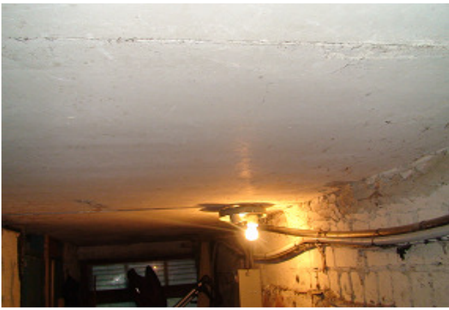
13 pav. El. instaliacija rūsyje
