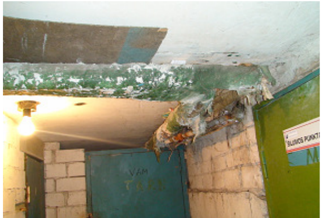
16 pav. Karšto vandens tiekimo vamzdynai
