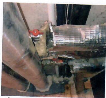
9 pav. Vamzdynų izoliacija
